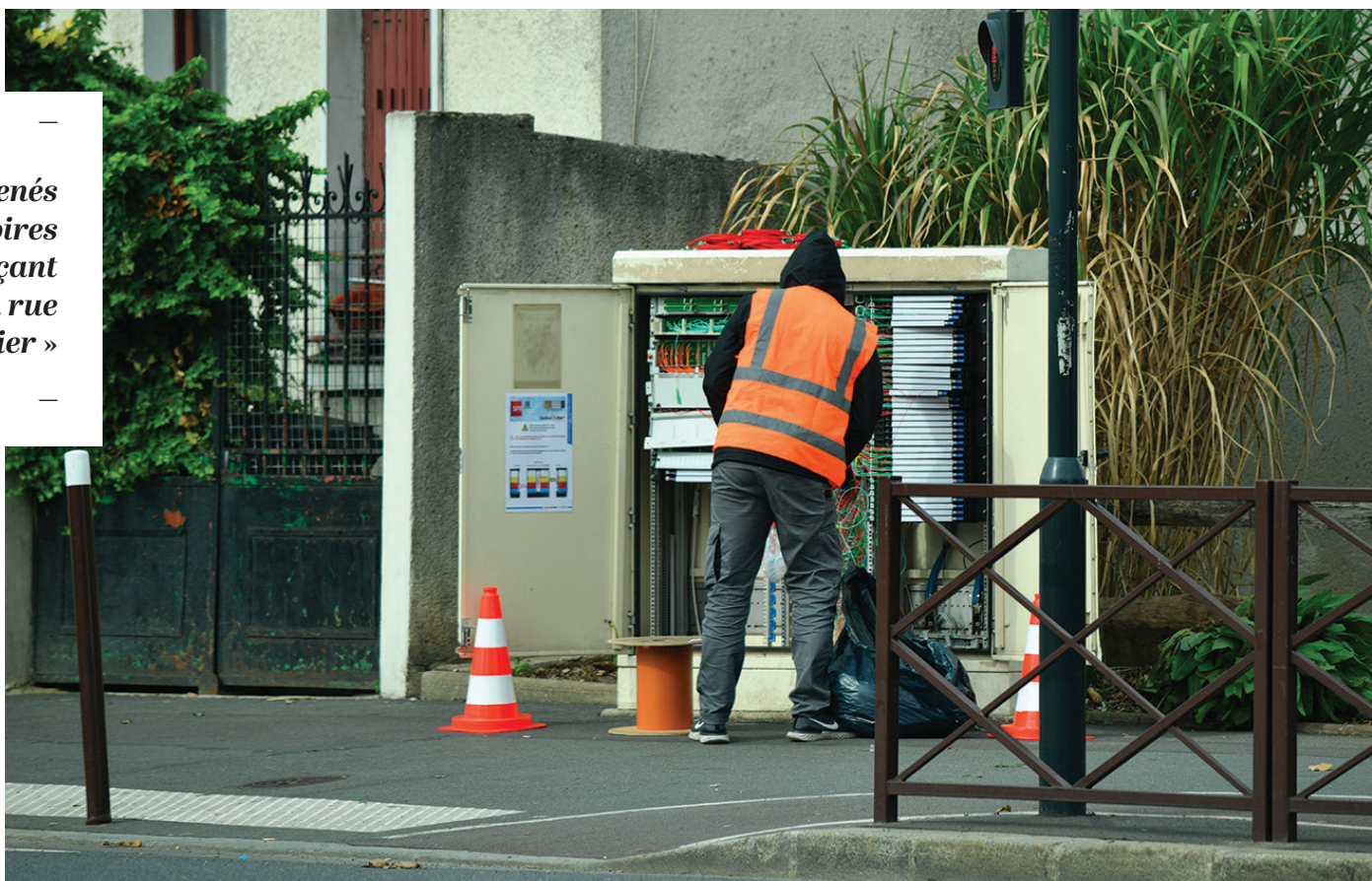
Un technicien s'affairant sur une de ces fameuses armoires.
